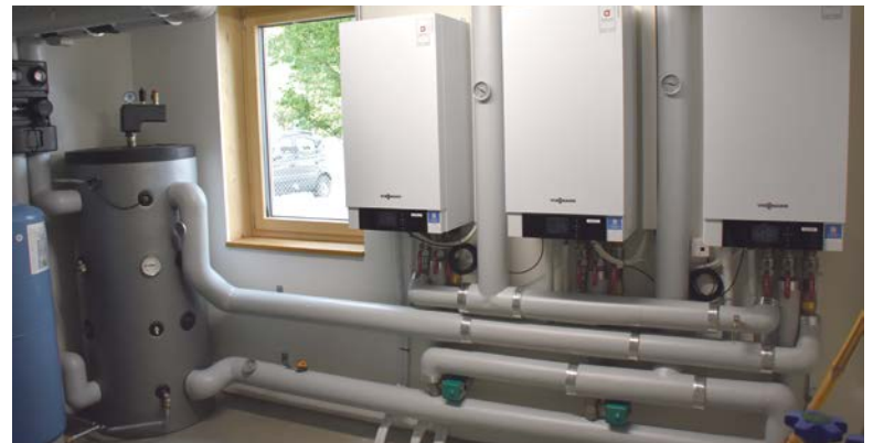
Die Haustechnik ist im Parterre untergebracht.
